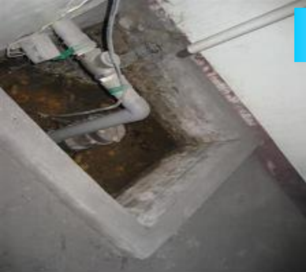
地下室儲水槽
