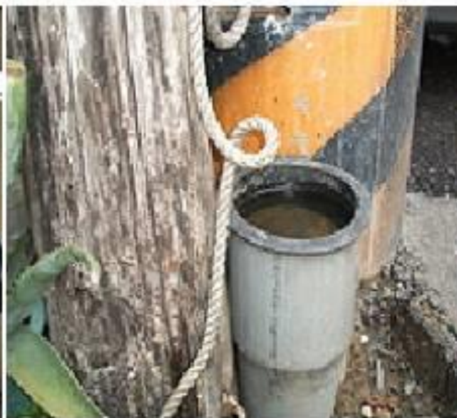
台電地下電纜引上管
