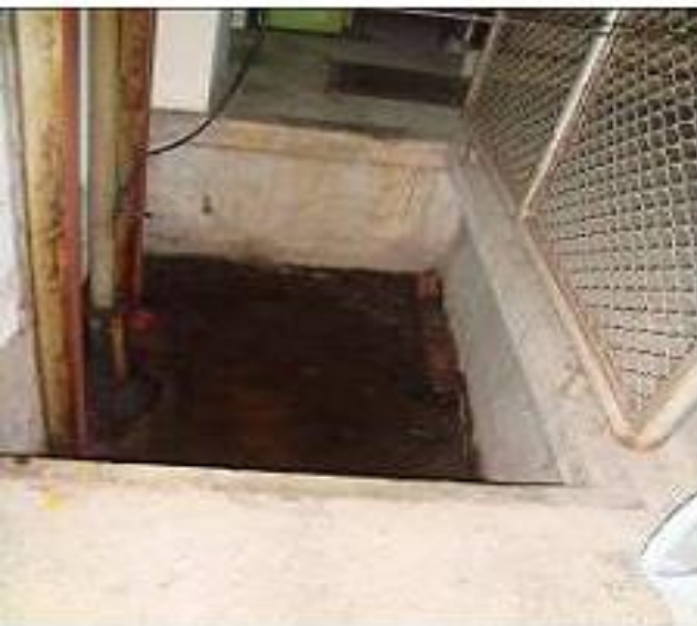
地下室之升降梯孔積水
