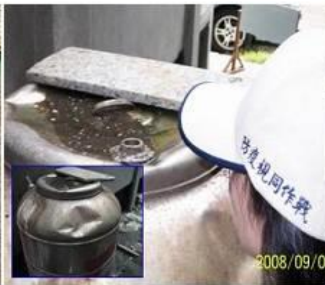
儲水桶鐵蓋凹陷處
