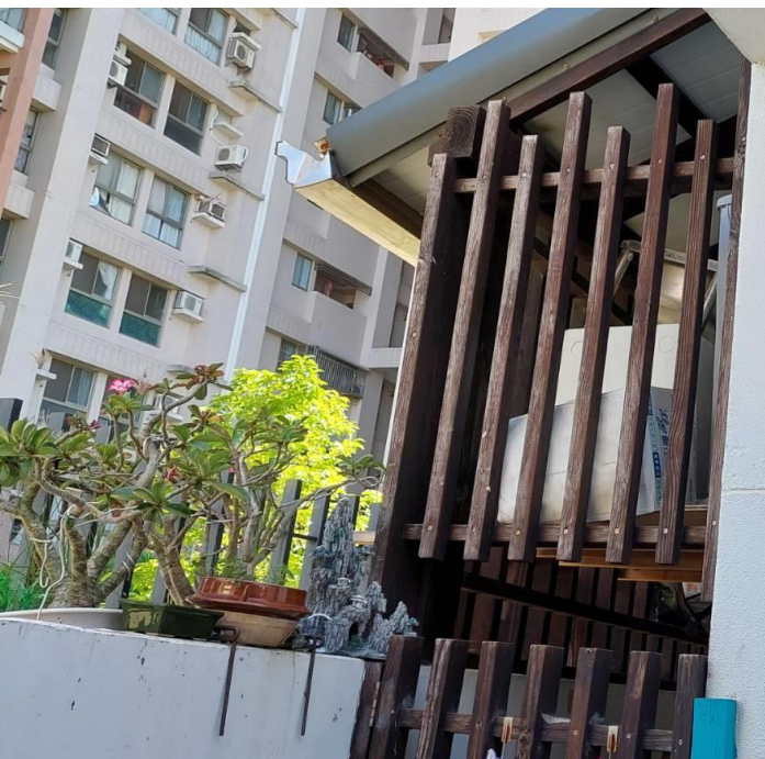
成功一街2巷17弄6號 ：左側天溝(緊鄰二空 國宅A1區)，積水孳生 登革熱病媒埃及斑蚊 子孓約80隻
